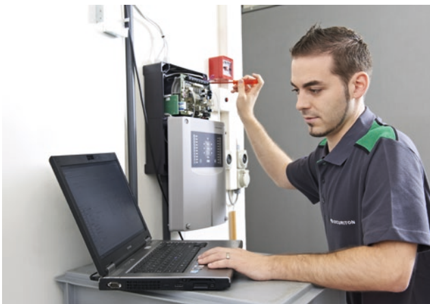
Der direkte Service-Einsatz am Sonderbrandmelder gehört dank Fernzugriff der Vergangenheit an.
