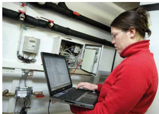
Abb.1: Einstellung der Systemparameter im Heizungskeller
