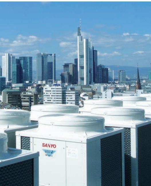
Außeneinheiten einer großen VRF-Multisplitanlage
