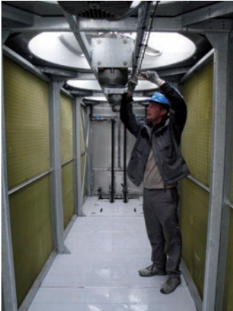
Abb.4: TOPAZ Trockenkühler mit adiabatischer Vorkühlung
