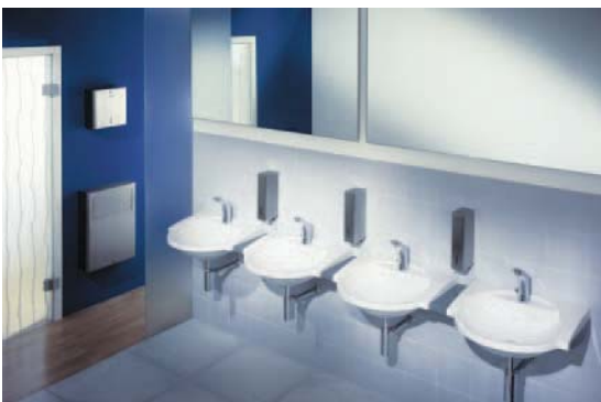
Abb. 5 Als Vandalen hemmendes Material hat sich Edelstahl bewährt, z.B. für Seifenspender, Händetrockner und Waschtisch. Der kunstharzgebundene Mineralwerkstoff „Rotolith“ von Aqua-Rotter ist hier aufgrund der besonderen Robustheit eine Alternative
