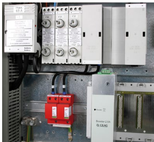
Abb. 1: Anwendung Blitzstrom-Ableiter DEHNsecure für Sicherheitsbeleuchtungssysteme
