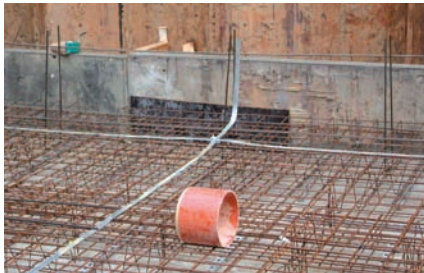
Abb.2: Niedrige Erdübergangswiderstände müssen schon in der Bodenplatte vorhanden sein – andernfalls sind zusätzliche Ring- oder Tiefenerder erforderlich
