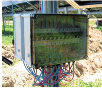
Abb.5 Verteilerkästen für die Parallel-Verschaltung von PV-Strängen (typischer Einsatzbereich: Anlagen mit kristallinen Modulen)
