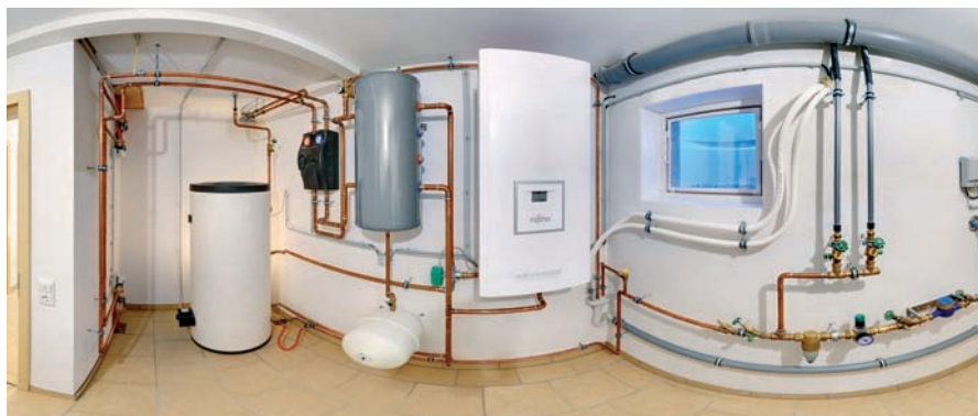
Abb. 1: Heizraum-Abwicklung mit Wärmepumpen-Inneneinheit, hydraulischem Trennspeicher, 3-Wege-Verteilventil und Wärmepumpen-Brauchwasserspeicher. Die Rohrleitungen sollen zudem mit einer Wärmedämmung versehen werden (zu Demonstrationszwecken hier nicht erfolgt).
