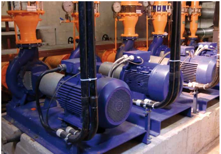
Abb. 1: In einer Kälteanlage zur Klimatisierung von Universitätsgebäuden transportieren vier Kühlwasserpumpen das Klimakaltwasser zu den Kältemaschinen. Mit je 30 kW Anschlussleistung ergibt sich für den Betrieb der Pumpen ein erheblicher Stromverbrauch.
