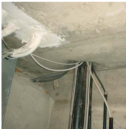
Ausführungsmängel in einer F 90-Massivdecke:
