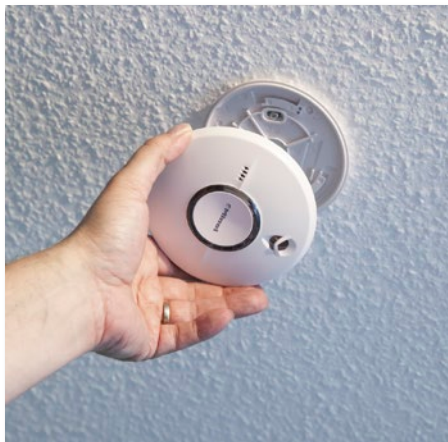
Abb.1: Auch bei den Dienstleistern gibt es große Unterschiede. Die Installation und Wartung sollte an eine „Geprüfte Fachkraft für Rauchwarnmelder“ delegiert werden.
