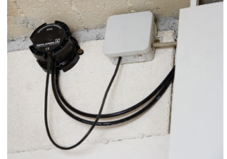
Elektronisch gesteuerte Differenzdruckanlagen messen die Druckverhältnisse im Treppen- raum. Drehzahlgesteuerte EC-Motoren passen in Bruchteil von Sekunden die erforderliche Luftmenge an.
