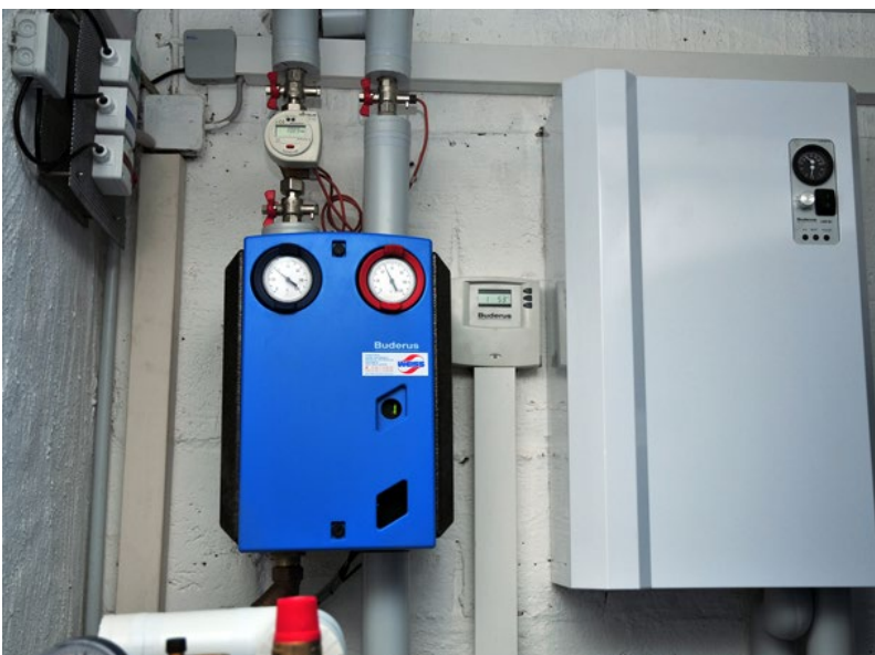
Abb. 3: Der Power-to-Heat-Elektroheizer (re.) liefert Wärme an den Speicher.
