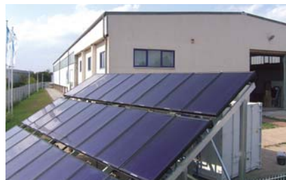
Abb.9 SAC-Komplettlösung aus Kollektorfeld und Kompaktinstallation im Container
