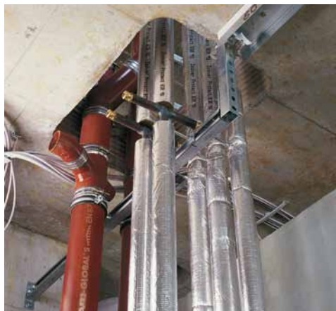
Abb. 1: Um eine Brandübertragung im Bereich von Deckendurchführungen zu unterbinden, müssen nichtbrennbare Gussrohre gegen benachbarte Rohre fachgerecht abgeschottet werden.
