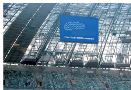
In Dachkonstruktion und Membranhülle integriertes Luftverteilsystem
