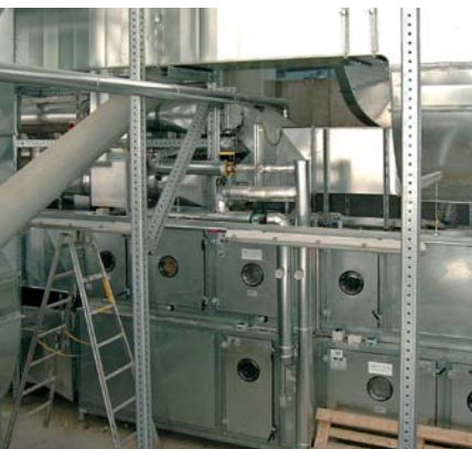
Kollisionen mit der Konstruktion: trotz 3D-CAD-Zeichnungen nicht immer zu verhindern
