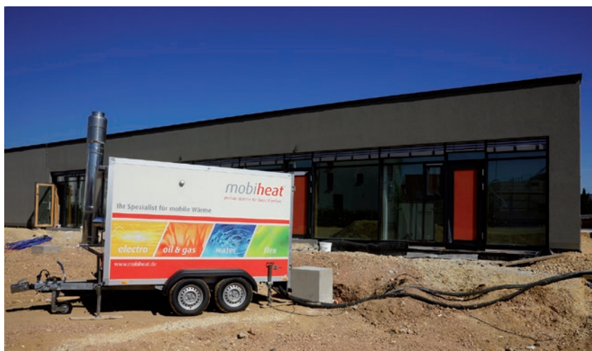
Abb.5: Zur Estrichrocknung eines Kinderhauses nutzte die Stadt Regensburg eine mobile Heizzentrale von mobiheat. Die Wärme wird über entsprechende Leitungen und Anschlüsse an das bereits installierte Heizungsrohrsystem angeschlossen.
