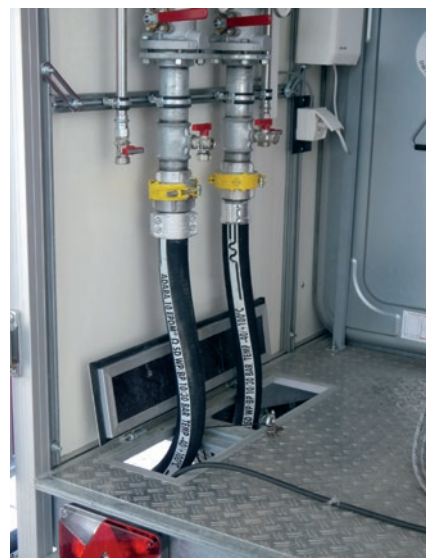
Abb.4: Das Heizungsrohrsystem wird mittels Schläuchen mit dem Heizungs- und rücklauf in der Heizzentrale verbunden. Ein flexibles sowie temperatur- und druckbeständiges Schlauchmaterial eignet sich auch für schwer zugängliche Gebäudeanschlüsse.
