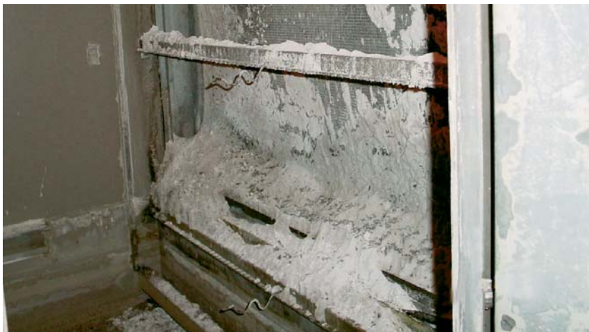
Abb.3 Nach einmonatigem Betrieb mit einer Klima-Luft-UV-OX-Anlage wurden in diesem Einsatzfall die Inkrustationen als feinsten Staub in der Wäscherkammer abgebaut
