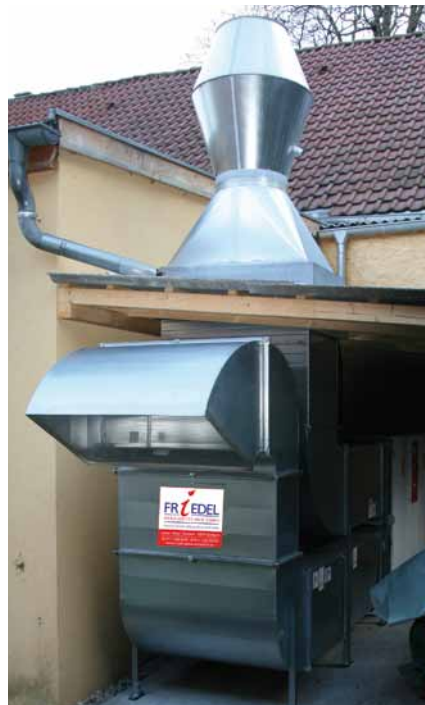
Abb.2: Kompaktlüfter im dafür gebauten Unterstand
