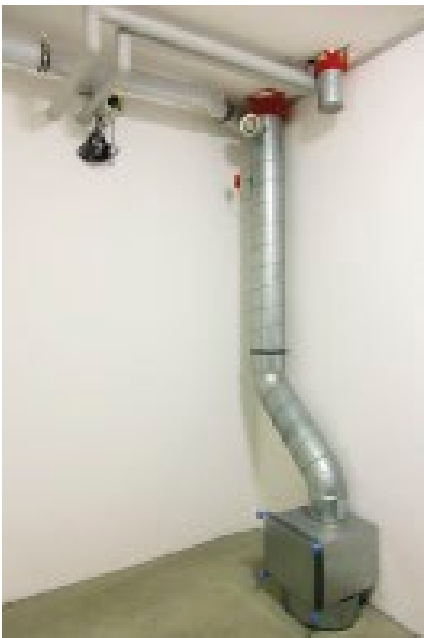
Abb.3: Die Komfortlüftungsgeräte in den Wohnungen werden über Steigleitungen mit vorgefilterter Außenluft versorgt. Diese strömt durch Luftkanäle aus hygienischem Kunststoff unterhalb der Tiefgarage, so dass die Luft im Sommer gekühlt und im Winter vorgewärmt wird.
