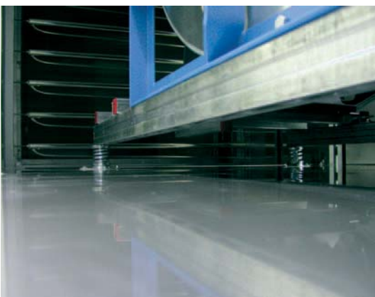
Abb. 6 Boden unter Ventilator
