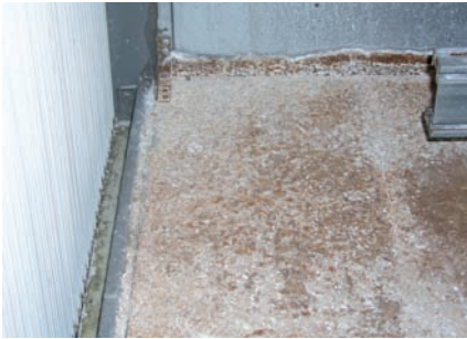
Abb.4: Seitenbleche und Bodenblech mit Korrosion und Ablagerungen nach dem Tropfenabscheider
