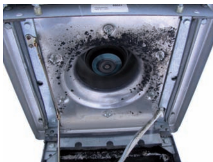
Abb.3: verschmutzter einseitig belasteter Ansaugbereich des Abluftventilators
