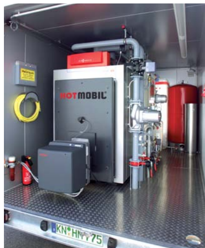
Abb.1 Heizzentrale mit modernster Heiztechnik
