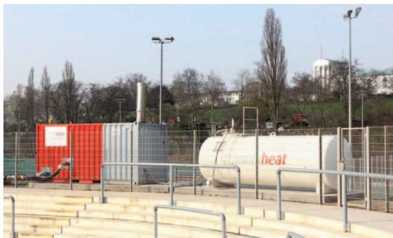
Abb.3: 1 MW-Rasenheizung in einem Fußballstation
