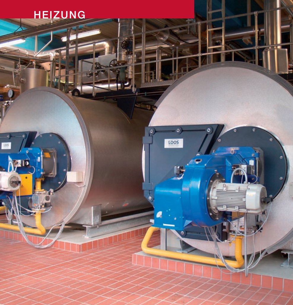
Abb. 1: Großraum-Dampfkessel in einem Industrieunternehmen
