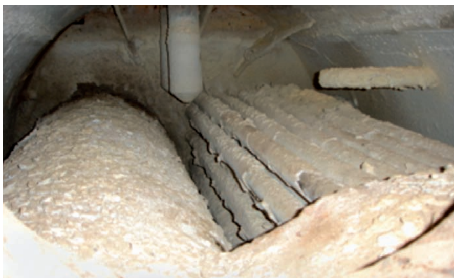
Abb.2: Folgen einer mangelhaften Härteüberwachung
