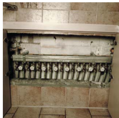
Abb. 2 Alte Fußbodenverteiler besitzen meist keine integrierten Ventile, sondern angebaute Durchgangsventile
