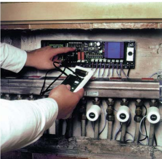
Abb. 1 Da die Raumthermostate nicht mit dem Hauptregler verkabelt werden, ist eine nachträgliche, wirtschaftliche Installation der Einzelraumregelung möglich.
