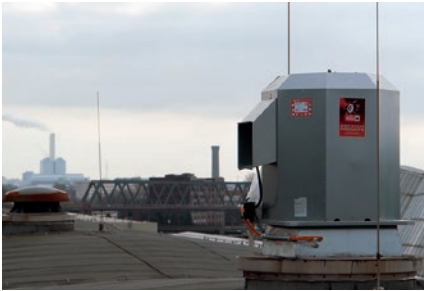
Abb.3: Zwei Brandgas Dachventilatoren sorgen dafür, dass die Rauchgase an der Decke des Theaters zuverlässig abgesaugt werden.
