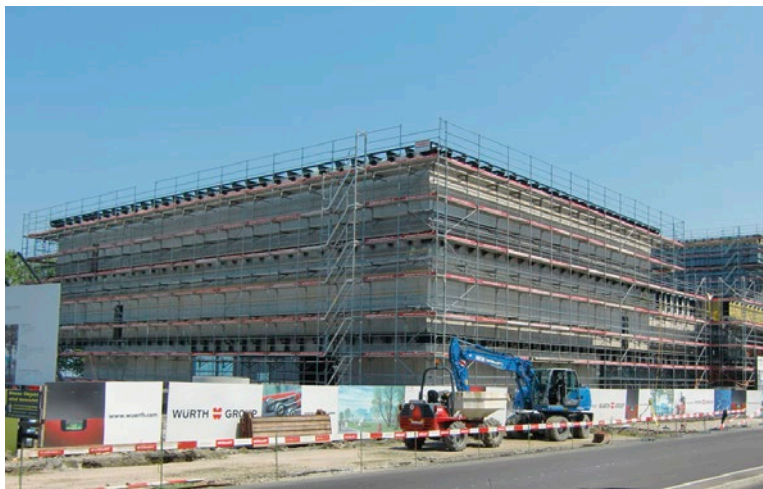
Abb.1: Feststehende Fertigstellungstermine erlauben bei der Erstellung von Bauobjekten keine Unterbrechung des Bauablaufs. Eine energieeffiziente Winterbauheizung mit indirekter, wassergeführter Beheizung sichert den Baufortschritt und vermeidet hohe Energiekosten.
