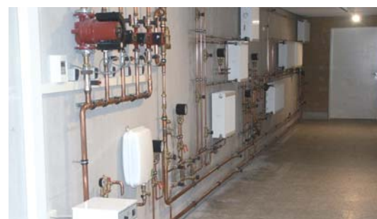
Labor für Hydraulik der FH Biberach. Energiesparen in hydraulischen Netzen: Überprüfung der Wärmeverteilung in optimierten Systemen mittels einer Infrarotkamera
