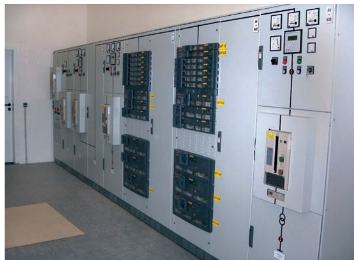
Abb. 1 Niederspannungshauptverteilung im DG innerhalb der Zentralküche des Klinikums Bremen-Mitte Foto: Ingenieurbüro Pachaly
