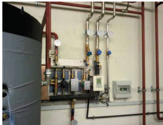
Abb.3: Feldtest in der Warmwasserversorgung eines Einfamilienhauses mit 18 Wohneinheiten:
