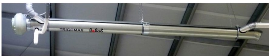
Abb. 2: Effizienzwächter: Der Trigomax entzieht der heißen Abluft die Wärme und führt sie als Warmluft in den Hallenraum zurück.
