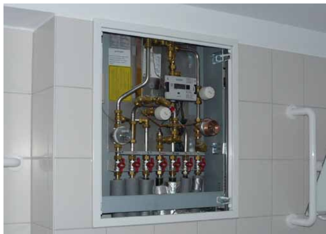
Abb.4: Wohnungsstationen können sehr platzsparend und optisch zurückhaltend installiert werden – hier beispielsweise im Bad.
