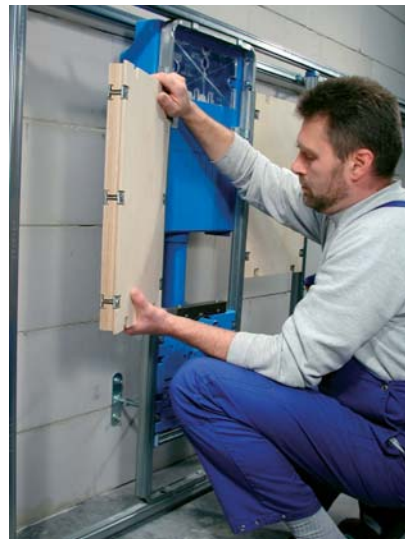
Abb.3 Installation der aus Holz gefertigten Unterkonstruktion zur Aufnahme der Stütz- oder Klappgriffe
