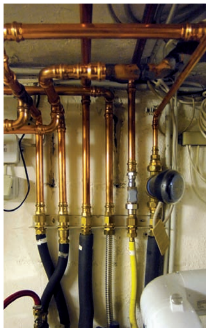
Abb.1 So darf es nicht sein! Durch ungedämmte Rohrleitungen werden Energie und Geld verschwendet.
