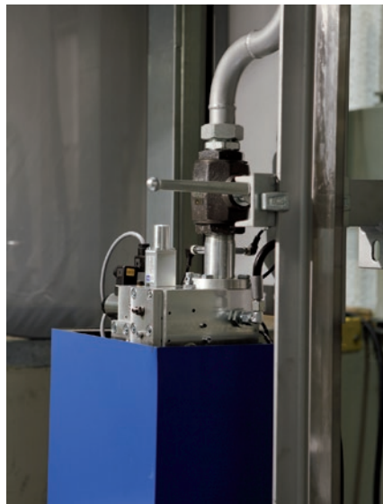
Abb.3: Hydraulikaufzüge neueren Datums und neuem Systemdesign ermöglichen eine wirtschaftliche und energieeffiziente Nutzung.
