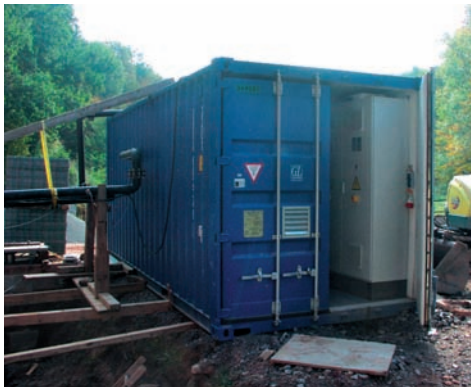
Abb.2 Aufbau der Ultrafiltrationscontaineranlage
