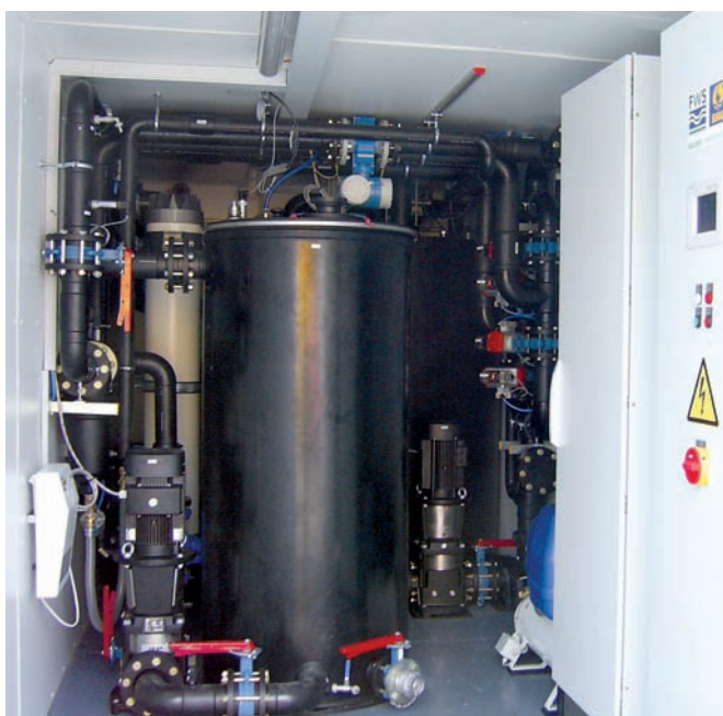
Abb.1 Einblick in die Verfahrenstechnik der Ultrafiltrationsanlage
