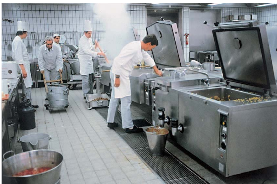
Abb. 1 Fettabscheideranlagen in Großküche
