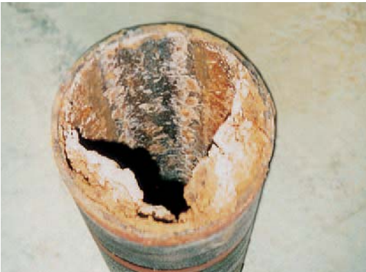
Abb. 3 Rohrverstopfung durch ausgehärtete Fette Werkfotos: Kessel
