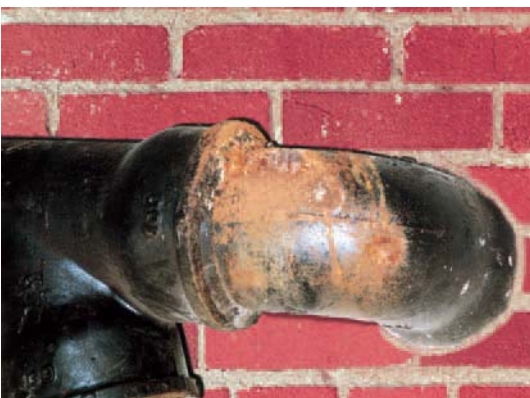
Abb. 4 Korrosion an Gußrohren durch Fettablagerungen innen (SML-Rohr)
